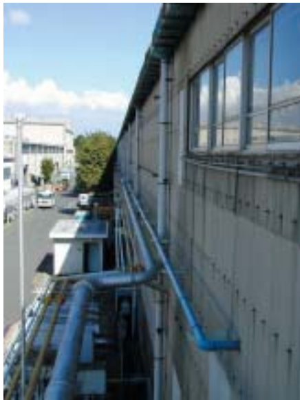
水道の架空配管
