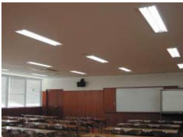
Hf型蛍光灯を使用したホールの照明
