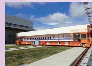
検修設備、車体トラバーサ
